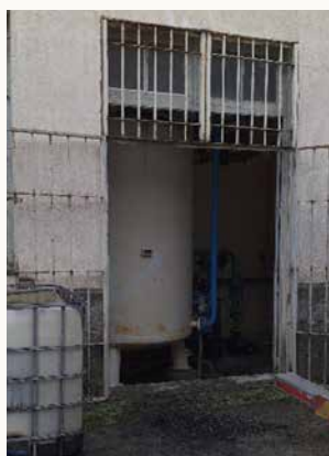
Unité de purification de l'eau de source de Fontevraud située dans l'abbaye.
